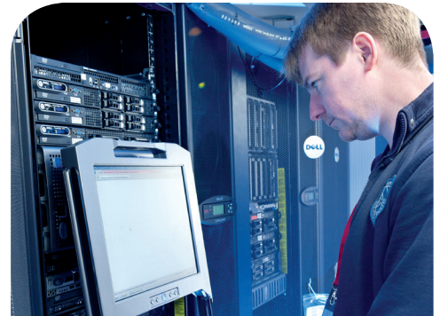
Überwachung der Haupt- und Archivserver
